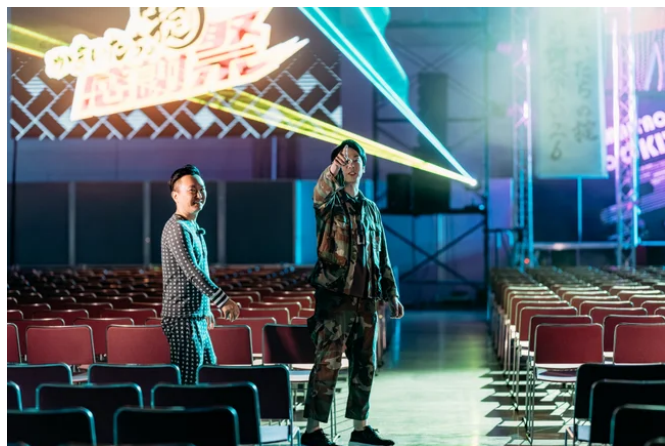
レーザーやLEDモニターを設置
